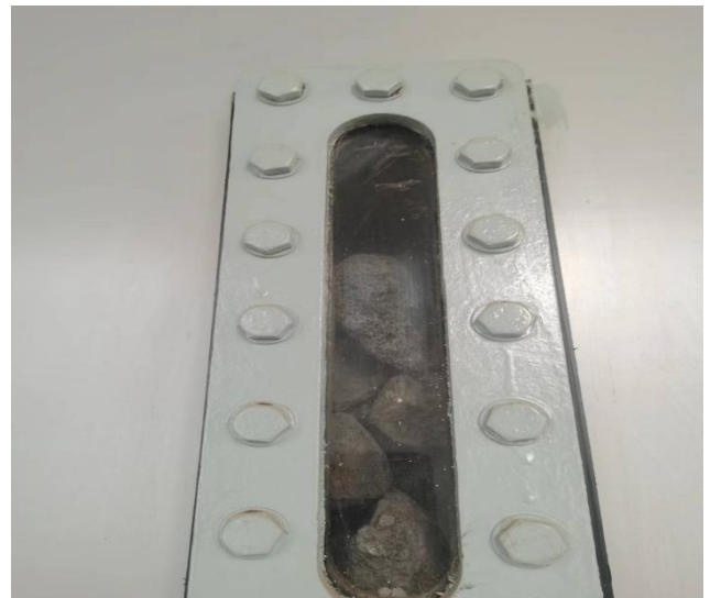
串湖污水厂除臭车间处理设备(2)
