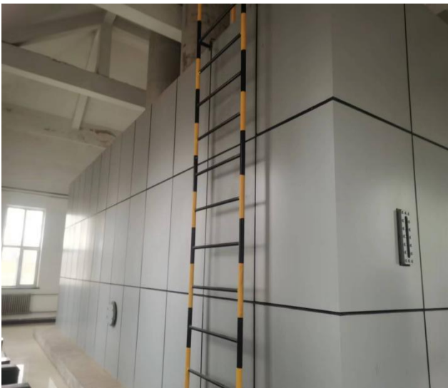
串湖污水厂除臭车间处理设备(1)
