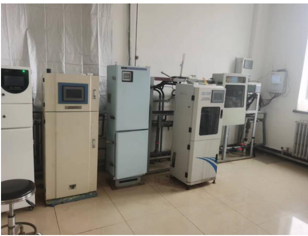
串湖污水厂在线监测设备
