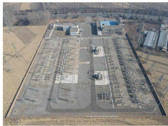
双阳 220kV 变电站东北侧
