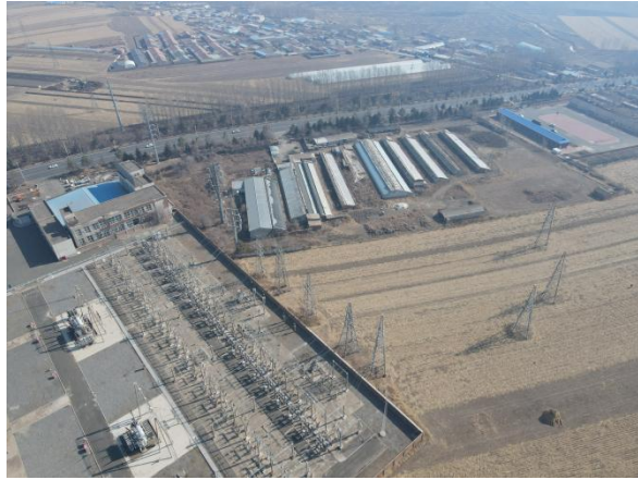
双阳 220kV 变电站东南侧
