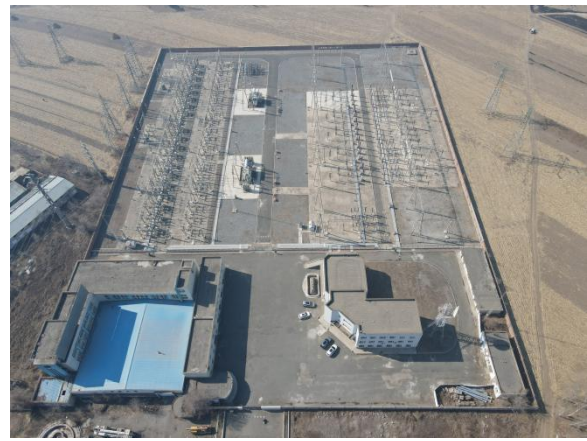
双阳 220kV 变电站西南侧
